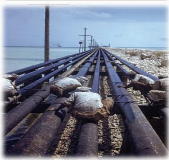
الصورة (١٢) أنابيب نقل النفط
