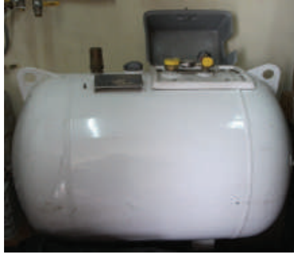
الشكل (27): خزان وقود غازي فوق الأرض.
