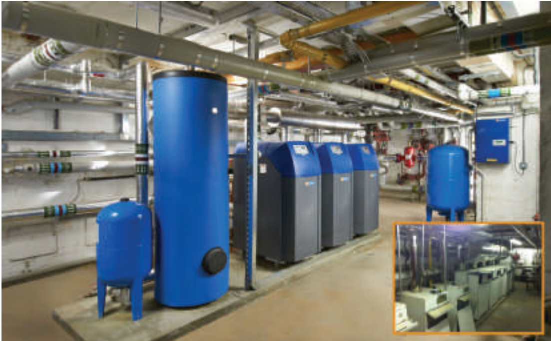
الشكل (11): غرفة مرجل.
