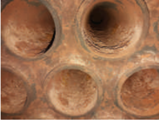
الشكل (9) : الصدأ داخل أنابيب ماء المرجل.
