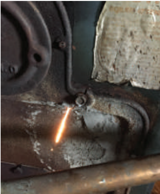
الشكل (10): كسر في سطح المرجل.
